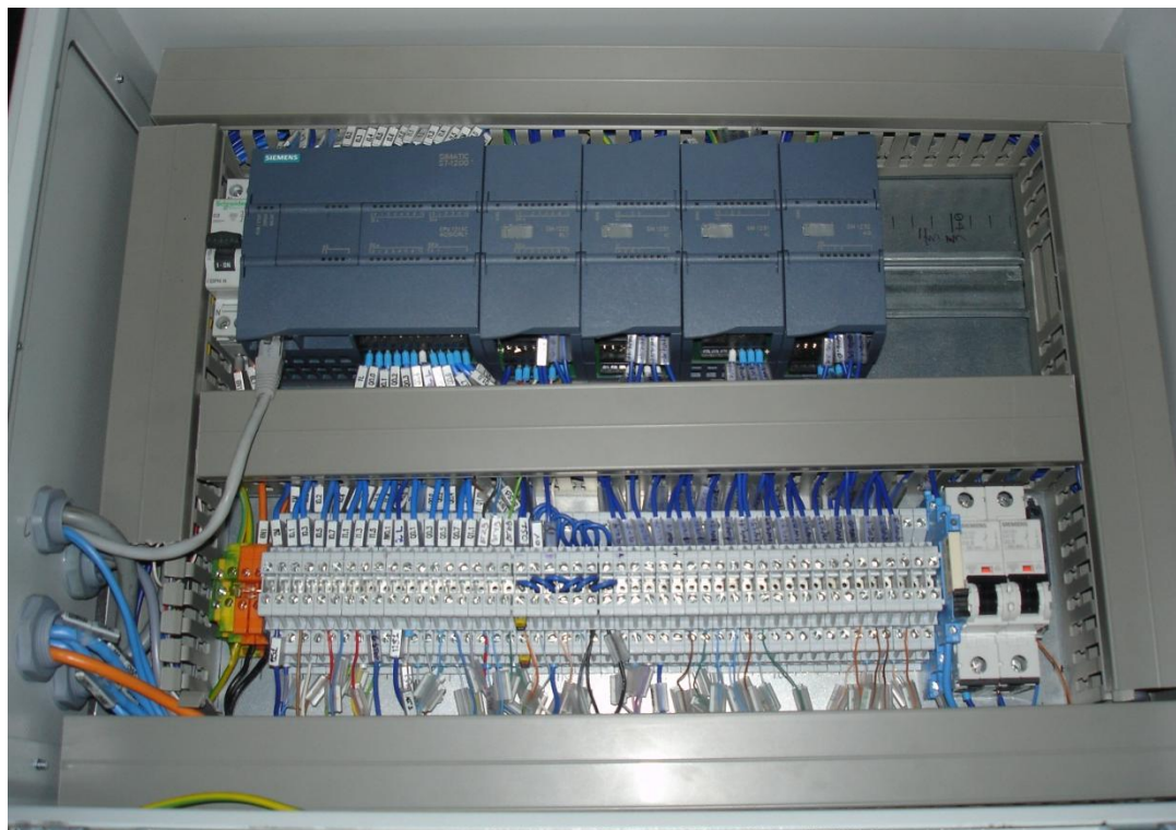
Figura 24 - Quadro eléctrico com o autómato do AtlasCar
