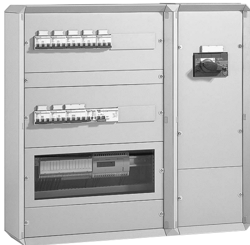
Interruptor Interpact instalado como interruptor de entrada num quadro de distribuição de potência Prisma G
