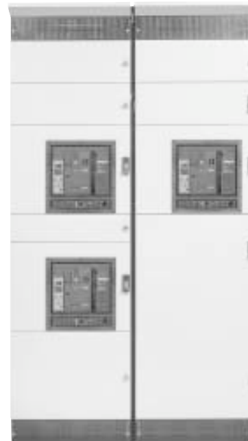
Encravamento de 3 Masterpact NW por cabos
